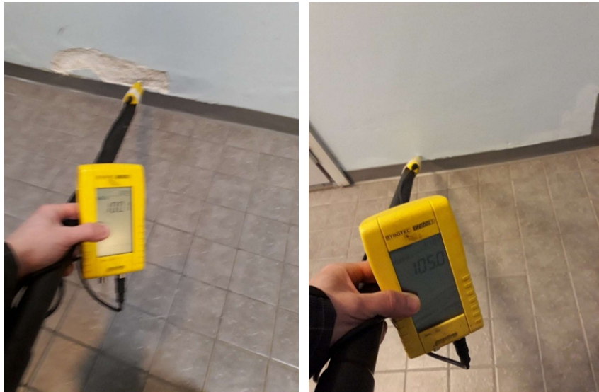
Kellarin seinien alaosissa on merkkejä kosteudesta (tilat 001 ja 005).
