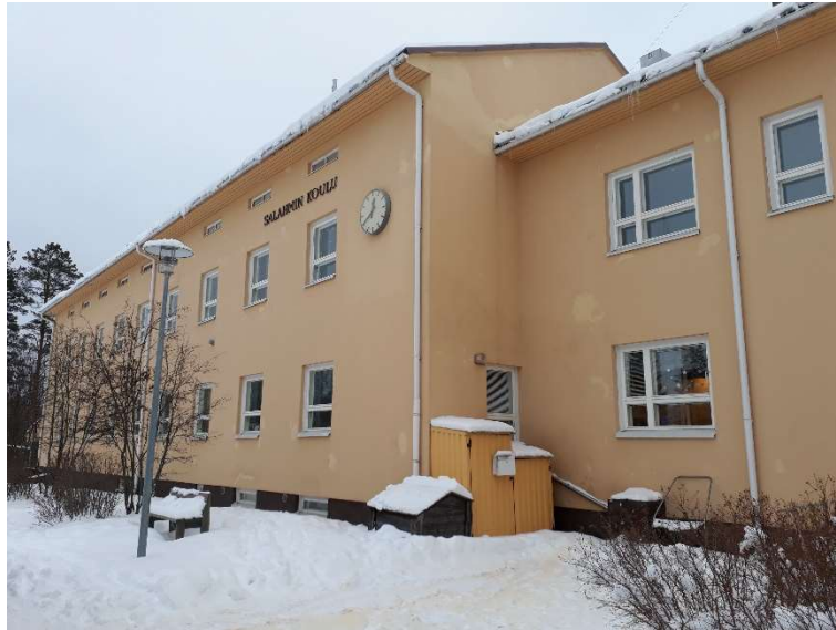
Julkisivurappauksessa on paikkausjälkiä.
