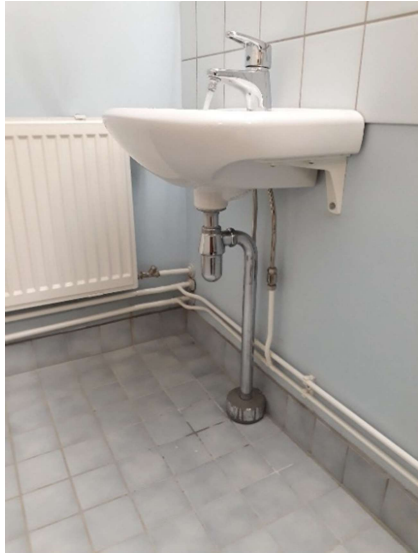
Vesijohdot ovat maalattua kuparijohtoa.
