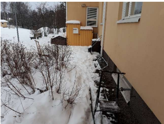
Istutukset ovat riittävän kaukana seinästä.
