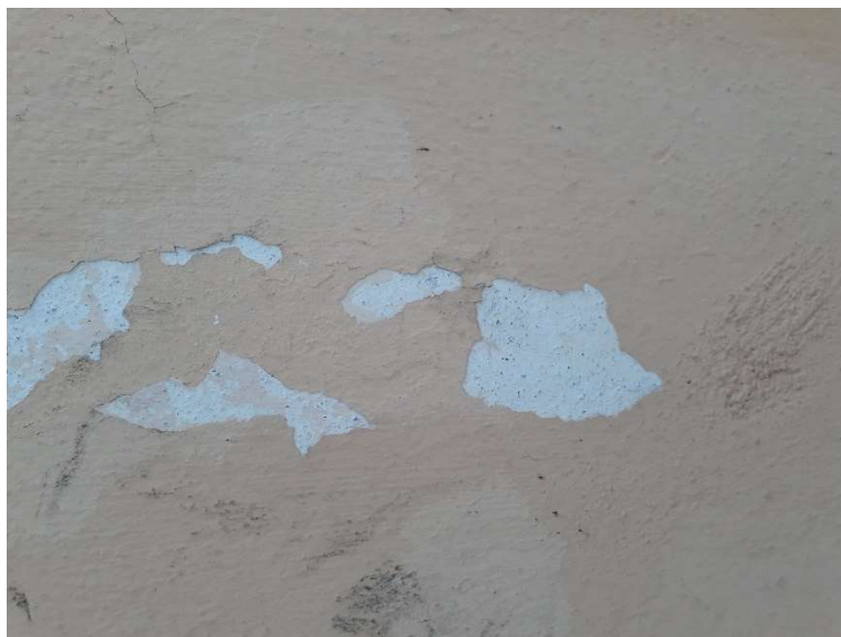
Paikoitellen maalipinta on irronnut alustastaan.
