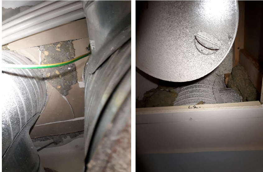
Kipsilevyä on käytetty välipohjan läpiviennissä valumuottina ja läpivientejä tukittu villalla.
