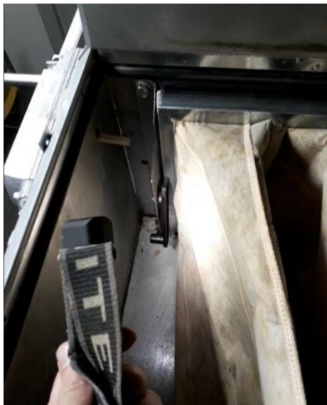
Tulosuodattimet ovat kiinnittämättä.
