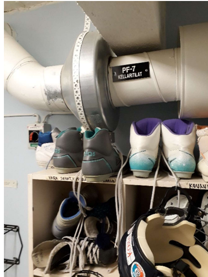
PF-7 kanavapuhallin palvelee osaa kellaritiloista.
