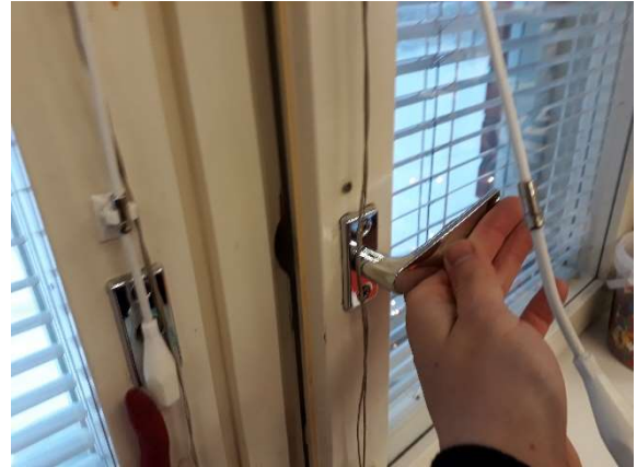
Luokan tuuletusikkunan kahva on löysä.
