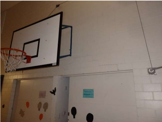
Useita hiushalkeamia liikuntasalissa etupihan päädysssä.
