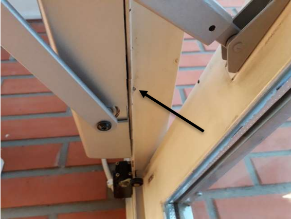
Ylipitkä ruuvi estää pääoven sulkeutumisen.
