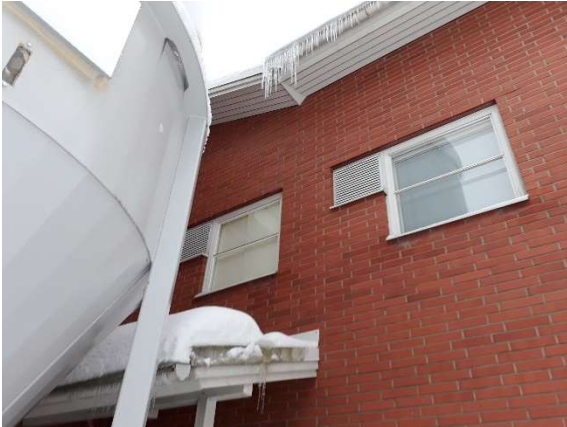
Jääpuikkoja räystäskourun yli.
