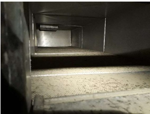
Raitisilmakanavassa reikäpelti + villa, ei muovia. rako.
