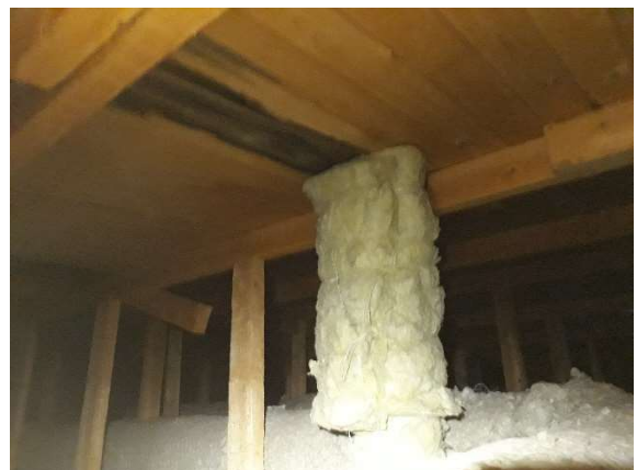
Toinen vuotojälki toisen tuuletusputken ympärillä.
