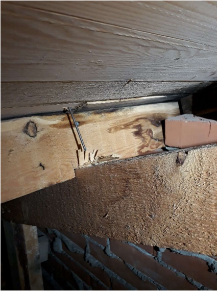
Kattovuotojälki ulkoseinän kohdalla.
