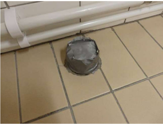
208 WC-pojat viemäri on tulpattu teipillä.
