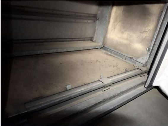
Raitisilmakanavassa on villapintoja.
