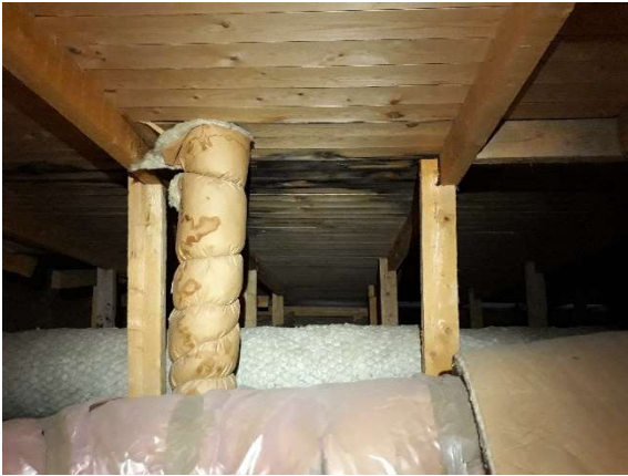
Läpiviennin ympärillä on vuotojälki.
