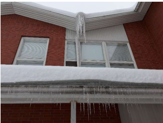
Syöksytorvi on jäätynyt.
