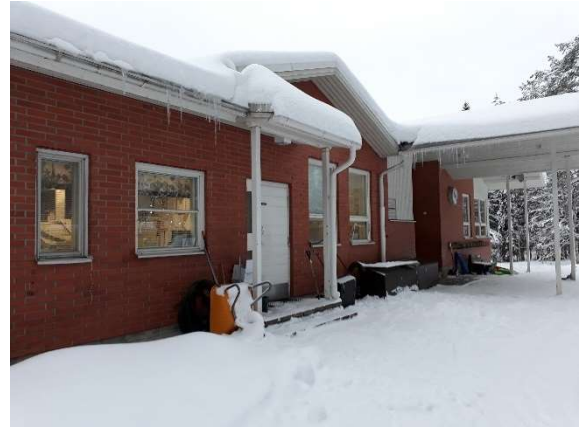
Jääpuikkoja räystäskourun yli
