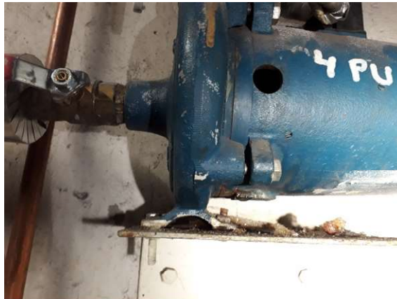
Pumpussa 4 PU 1 on tippavuoto.
