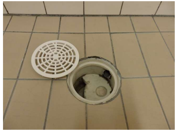
107 pesuhuoneen lattiakaivossa on epätiivis läpivienti ja epätiivis lattialaatan liittymä.
