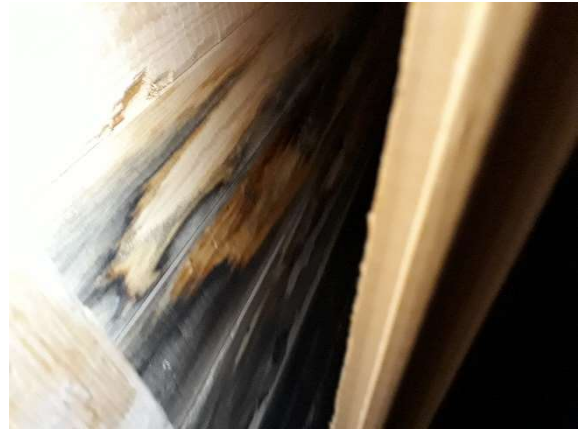
Katon sisäjiirin kohdalla on vuotojälkeä.
