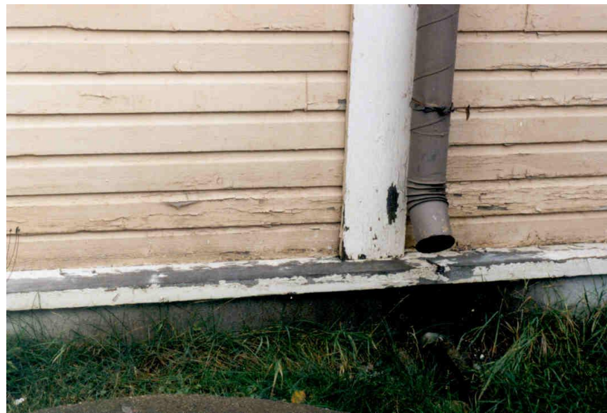
Koulukievarin julkisivumaalaus on paikoin rapistunut
